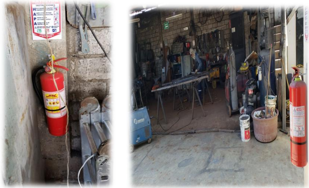
Figura 50: Ubicación de extintores
