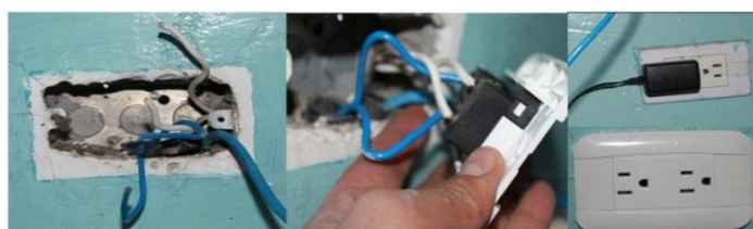
Nombre: Instalación eléctrica y conexión a tierra
